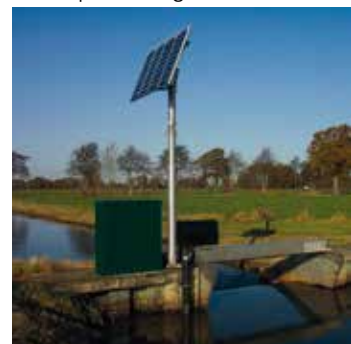
Alimentation servomoteur par énergie solaire
